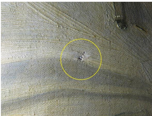
Repariertes Loch auf Höhe der Brust (Verso) (Anlage 11)
